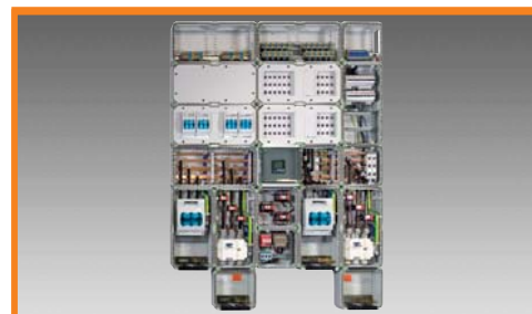
GTi – przykładowa rozdzielnia
